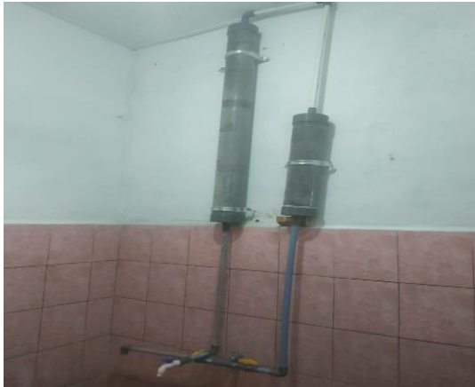
12. Alat filtrasi yang sudah terpasang di rumah Ibu Hs
