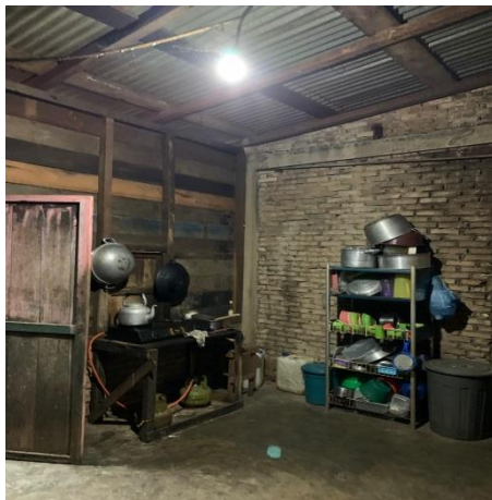
Kondisi Dapur yang tidak memiliki lubang asap
