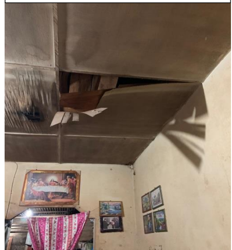
Kondisi Langit-langit rawan kecelakaan
