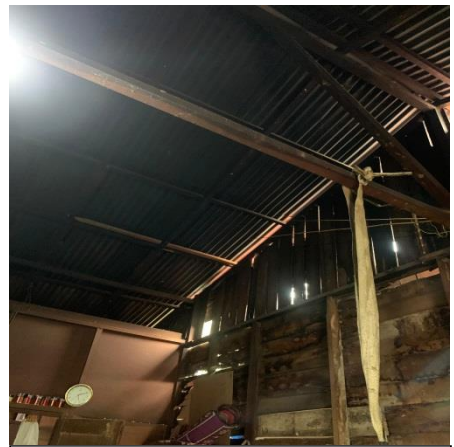
Kondisi Rumah Tidak memiliki langit langit
