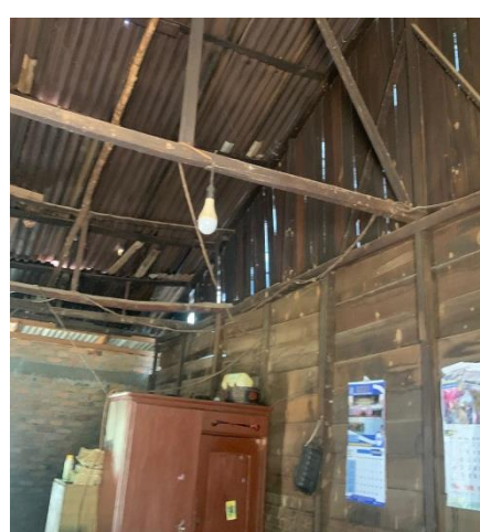
Kondisi Rumah yang tidak memiliki Ventilasi
