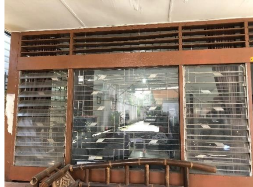
Gambar 2. Ventilasi dan jendela kantor
