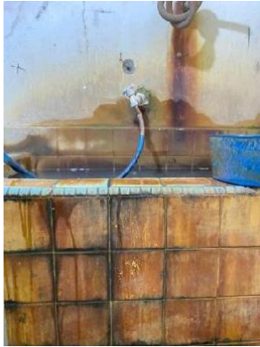
Dampak air yang mengandung kadar besi (Fe)
