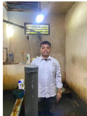
Dokumentasi alat filtrasi multimedia
