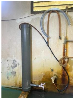
Dokumentasi alat filtrasi multimedia
