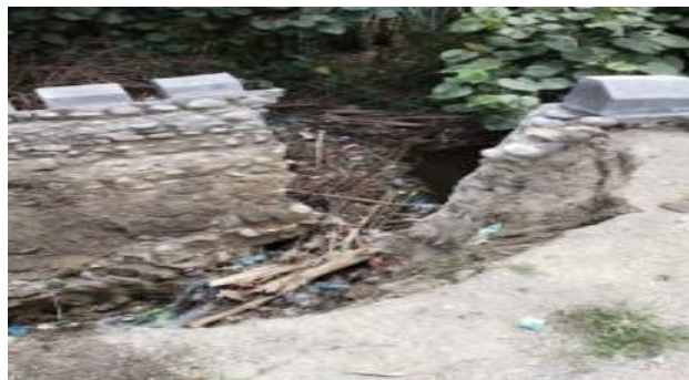
Jembatan rusak tersumbat sampah
