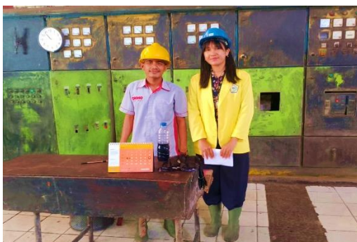
Ruangan kamar mesin pabrik
